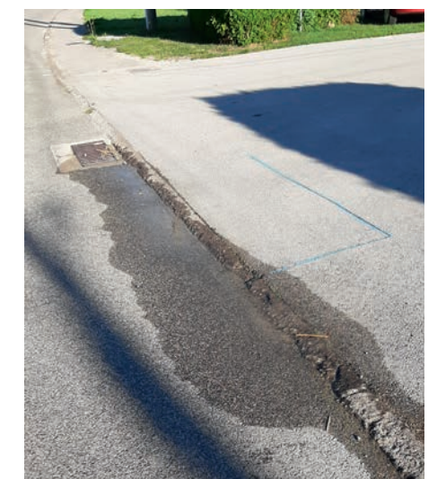
Fuite rue du Moulin à Frasne 2020
