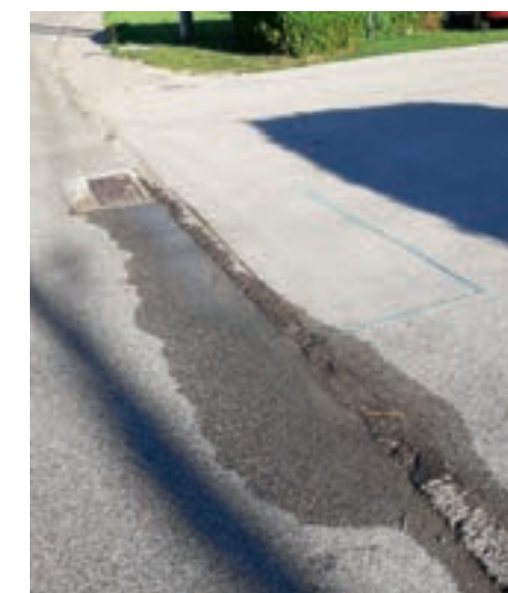
Fuite rue du Moulin à Frasne 2020
